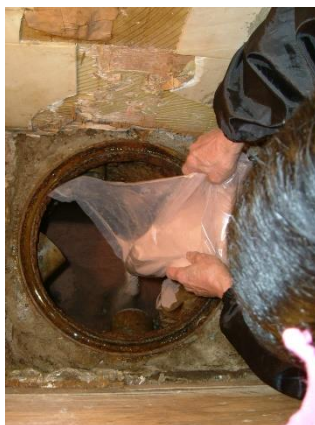
遊戯店のビルピットに使用
